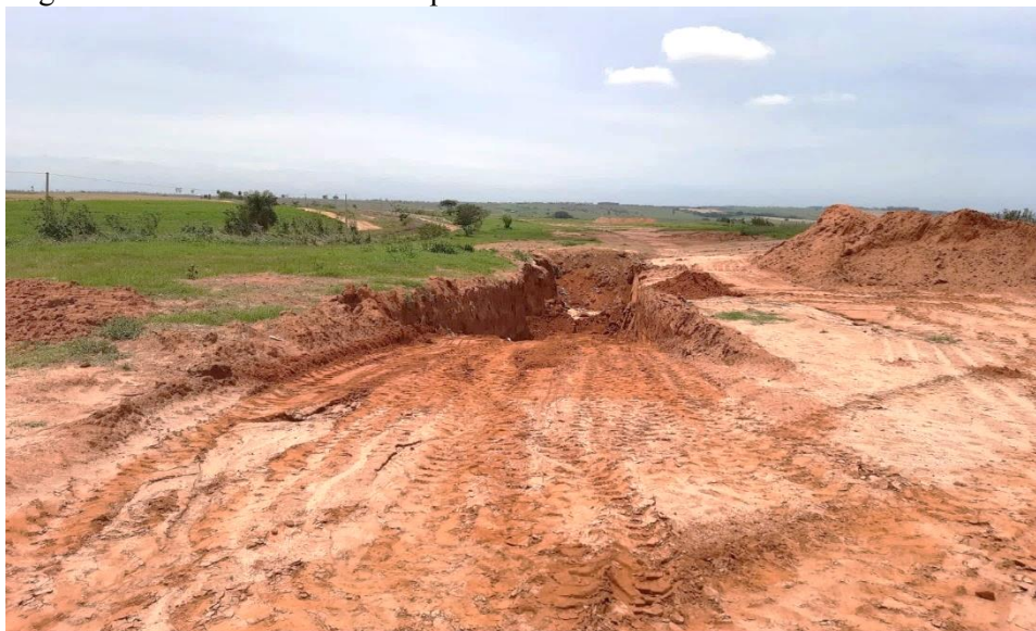
Figura 19: Vala do aterro municipal em uso
