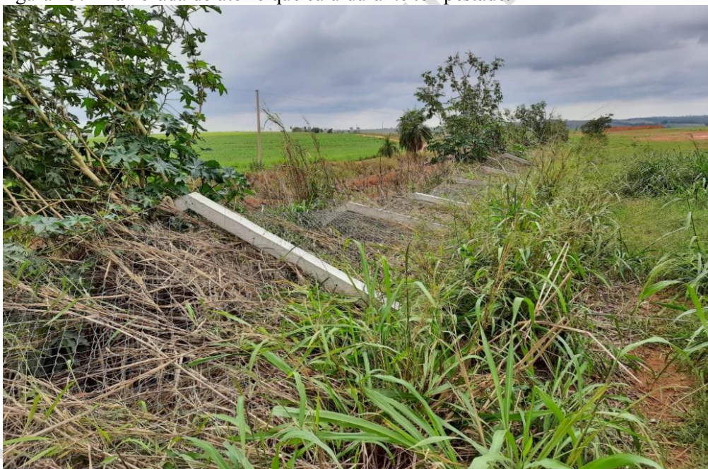
Figura 13: Alambrada do aterro que caiu durante tempestade.
