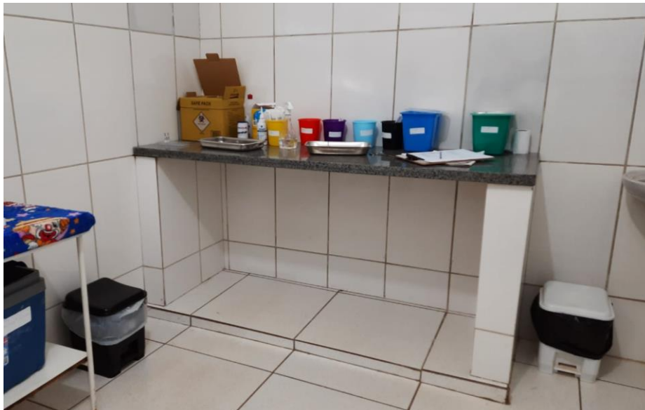
Figura 53: Acondicionamento dos RSS nas salas de atendimento da Unidade básica de Saúde Dr. José Rosseto.
