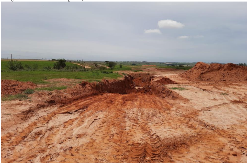
Figura 16: Vala em operação no aterro.
